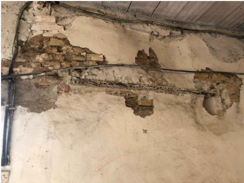
8) Particolare sondaggio con ritrovamento del vecchio architrave ligneo indicante un'antica apertura tamponata
