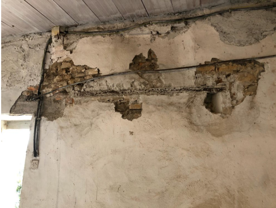
7) Particolare sondaggio con ritrovamento del vecchio architrave ligneo indicante un'antica apertura tamponata
