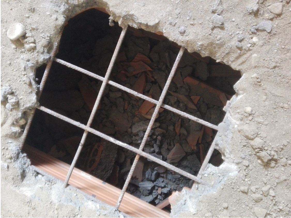
16) Particolare sondaggio solaio attuale "pranzo al piano terra" che evidenzia un riempimento con macerie provenienti da demolizione
