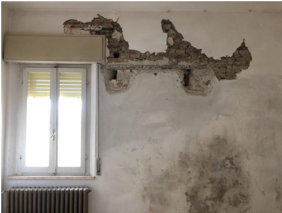
12) Particolare sondaggio con ritrovamento del vecchio architrave ligneo indicante un'antica apertura tamponata
